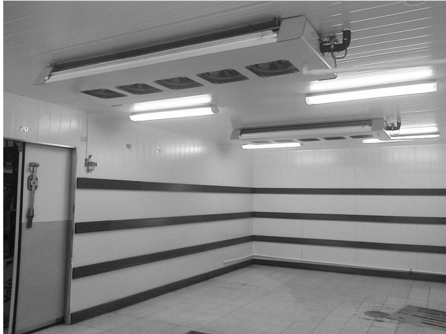
Kuva 61: SOK Hämeenmaan Lahden Prisman liha/eineskylmiö. Katossa T8-loisteputket ja kylmlaitteiston alayksiköt.
