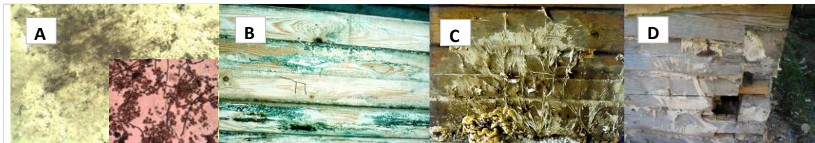
Kuva 5. Hajottajamikrobien sukessio rakennusmateriaaleissa: A, pintahome betonin pinnalla; B, puun sinistymä; C, lahovaurio puussa ja D, sekundaarihomeet ja -bakteerit, jotka elävät lahosienellä.
