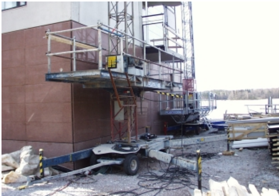
Kuva 5.23. Mastolavat Meritornin pohjoisseinustalla. 70 metriä pitkä sähköjohto ei toimi aina odotetulla tavalla; kerran johto katkesi kietouduttuaan mastolavan tukijalan ympärille ja toisella kerralla betonimylly nousi joitakin metrejä ilmaan, ennen kuin lava pysähtyi.
