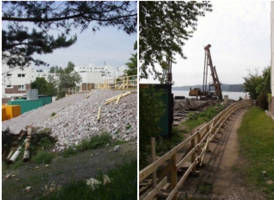
Kuva 2.2. Ensimmäisessä vaiheessa työmaatie tontille pengerrettiin viistosti alas. Etualalla näkyvä penger on rakennettu kääntöpaikan levennystä varten (vasen kuva). Tontin pohjoispuolella Meritornin ja viereisen rivitalonpäädyn välinen matka oli alle 10 metriä (oikea kuva).
