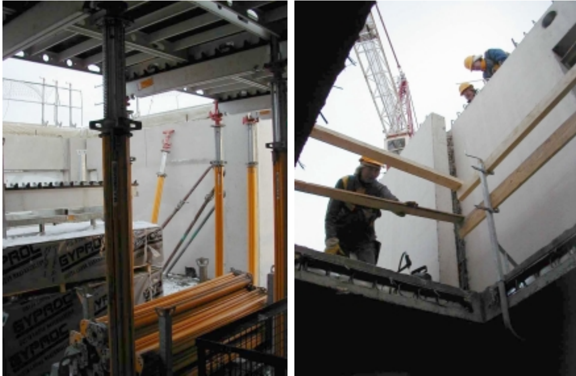
Kuva 5.15. Kuvassa on käynnissä muottien asennus (vasen kuva). Muottikalusto siirrettiin holviin jätetyn työaukon kautta kerrosta ylemmäksi (oikea kuva).
