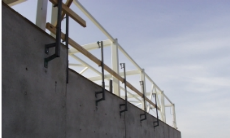
Kuva 5.8. Meritornissa käytetty vesikattokaiteiden ????, jonka perusosa kiinnitettiin maassa elementissä oleviin vemoihin???? Käsijohteena käytetään 50 x 100 sahatavaraa, ja tolppaväli on enintään 2,5 m.
