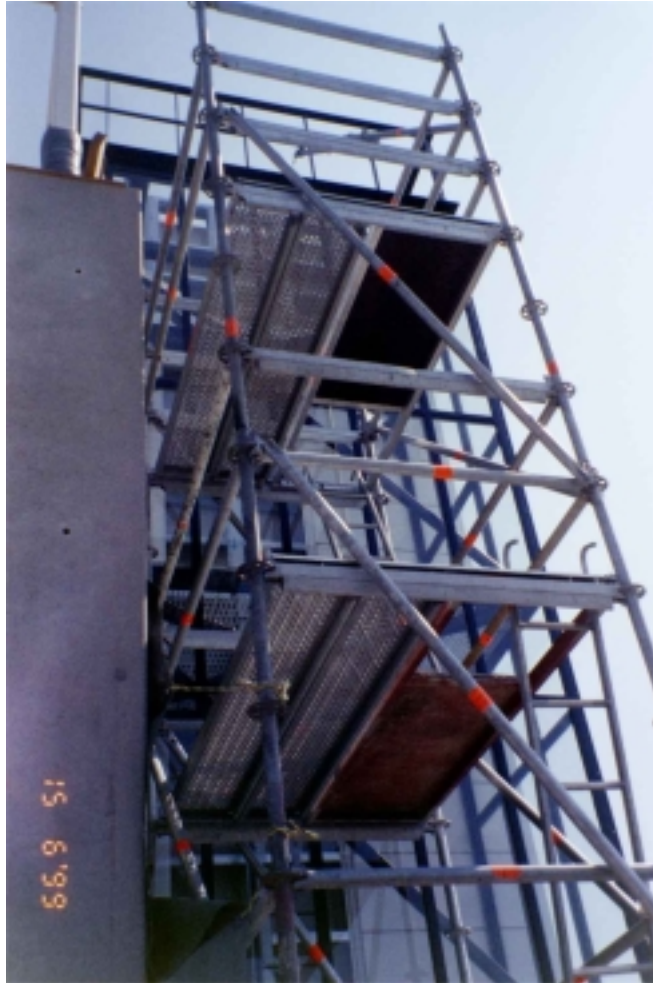
Kuva 5.25. Rakennuksen rungon ulkopuolelle rakennettu teline, jota käytettiin ylimmän parvekkeen (nelosparveke) viimeistelytyöissä (kesäkuu 1999).
